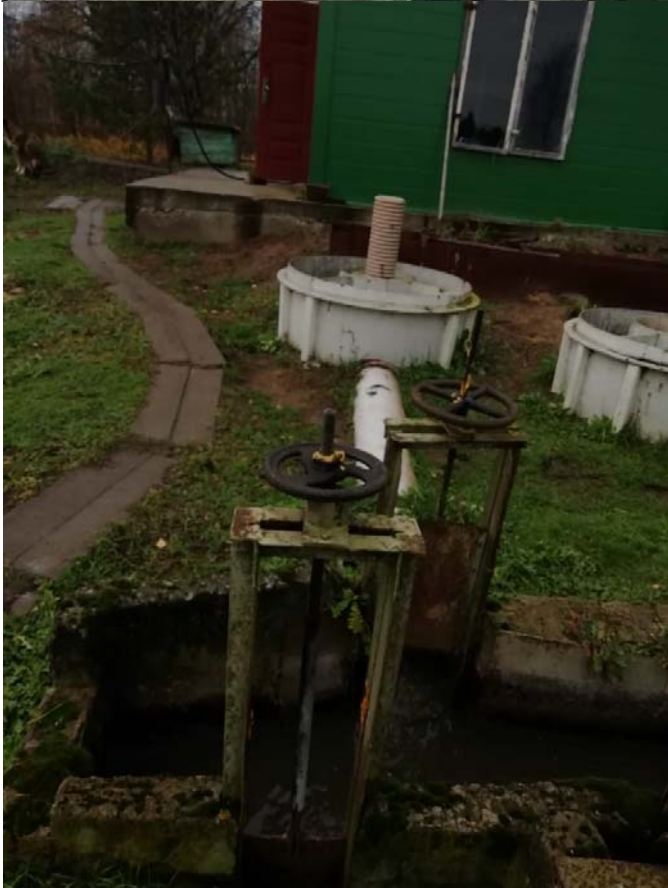
Рисунок 15- Распределительный лоток перед заротенками.
